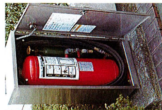
移動式粉末消火設備 (団地共用、駐車場設置)
