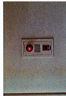
非常警報装置 (棟共用、12号棟のみ)
